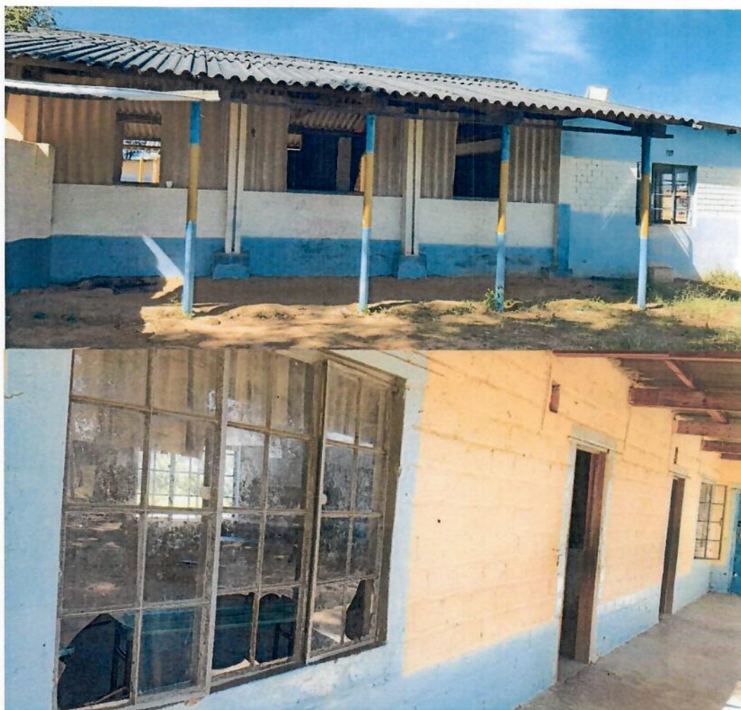
Photo 1. Etat actuel de l'école Complexe Saint Jean Bosco de Lonshi
