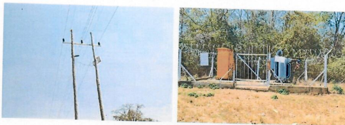
Photo 2. Le réseau électrique dans le village Lonshi
