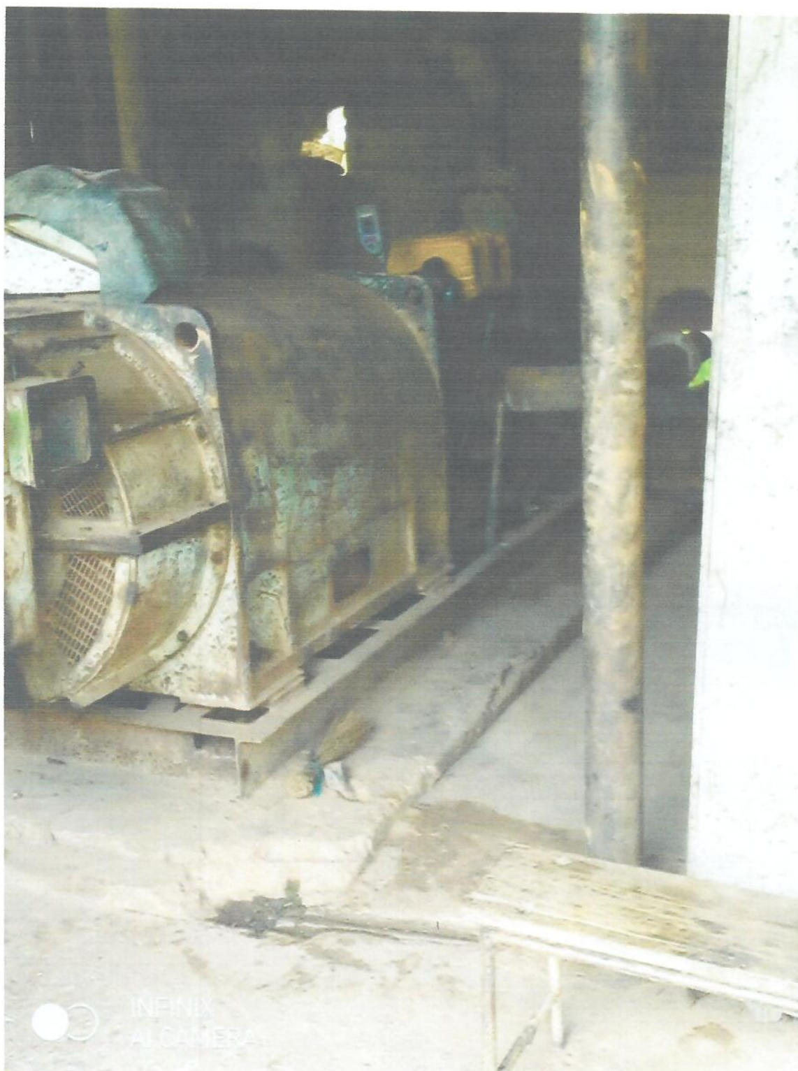
Type de moteur électrique associé à chaque pompe, en bon état
